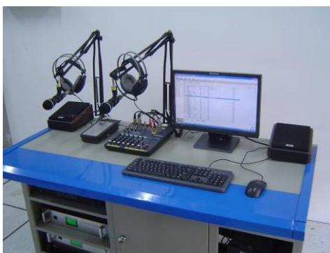
Рис.6.1.1. Пример комнаты оборудования
